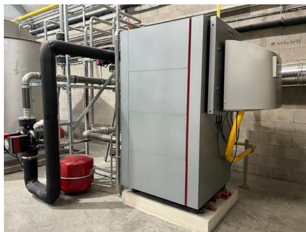
Chaudière process blanchisserie
